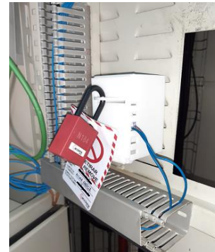
Consignación de la alimentación de 24V del display. Lock out and tag out of the 24V power supply of the display.
