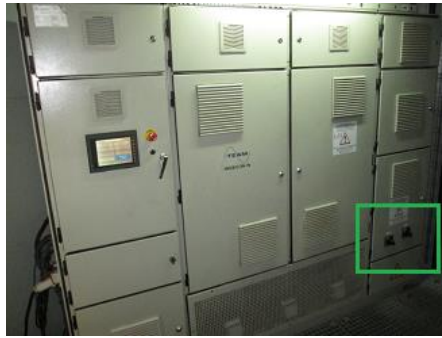
Armario ground, resaltado en verde la ubicación del interruptor Q5. Ground cabinet, the location of the Q5 switch is highlighted in green.
