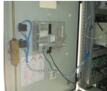
Consola vista por la parte trasera. Display seen from the rear.
