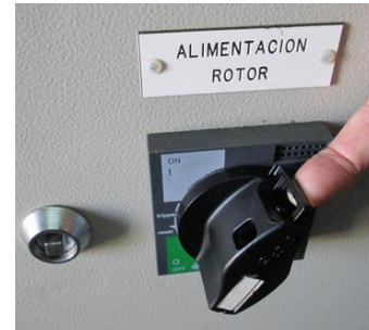
Seccionador Q5 en posición abierto. Sólo en esta posición se puede extraer la pestaña de enclavamiento. Q5 switch - rotor power closed under normal operation conditions.
