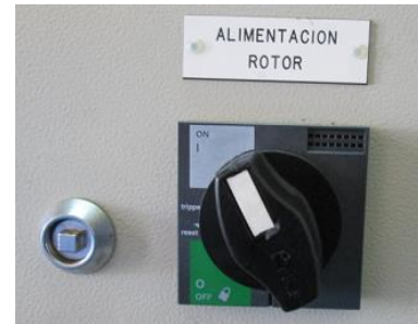
Interruptor Q5 – Alimentación Rotor cerrado, en condiciones de operación. Switch Q5 - Power supply Closed rotor, in operating conditions.
